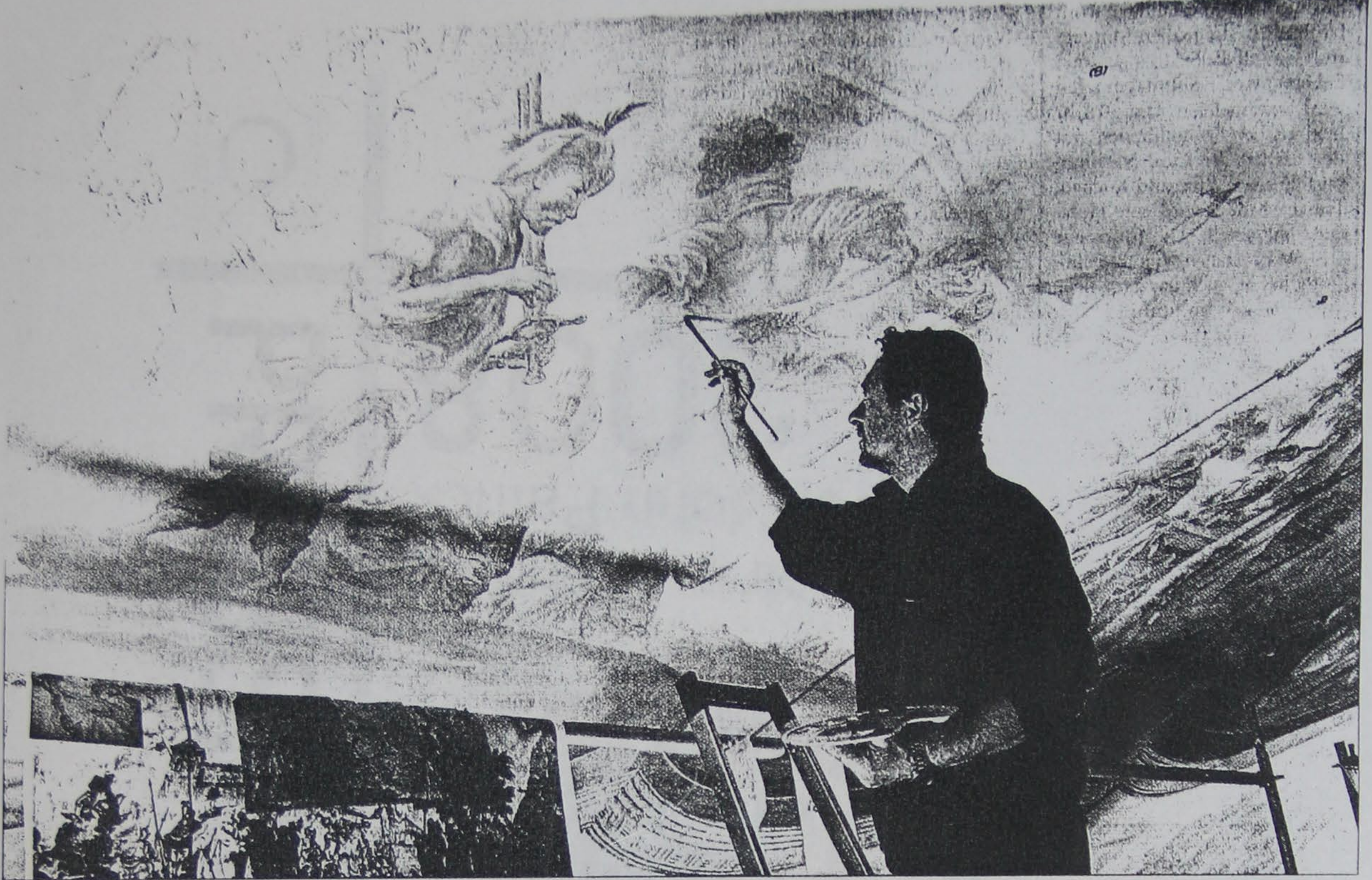
Bis zu zehn Stunden täglich beschäftigt sich der Maler und Restaurator Wojtek Wellenger mit der Sanierung des Deckenfreskos von Johann Baptist Enderle in der Pfarrkirche Sankt Peter und Paul. Bis zum Oktober soll die Restaurierung abgeschlossen sein. Foto: Hans Nietner
